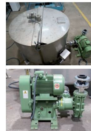
4 Deposito Lodos Réservoir Boues Deposit Muds
